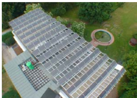
на фото: солнечные панели на крыше обновленного конференц-центра РЭЦ ЦВЕ
